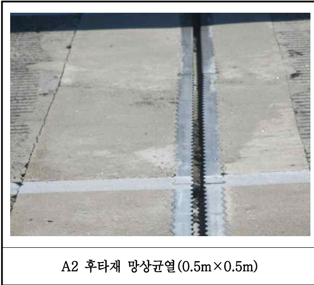
【사진 21.3.17】 신축이음장치 손상현황
