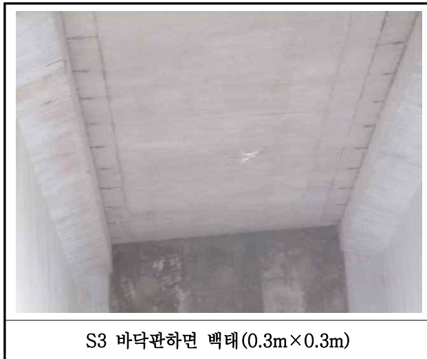
【사진 21.3.3】 바닥판하면 손상현황
