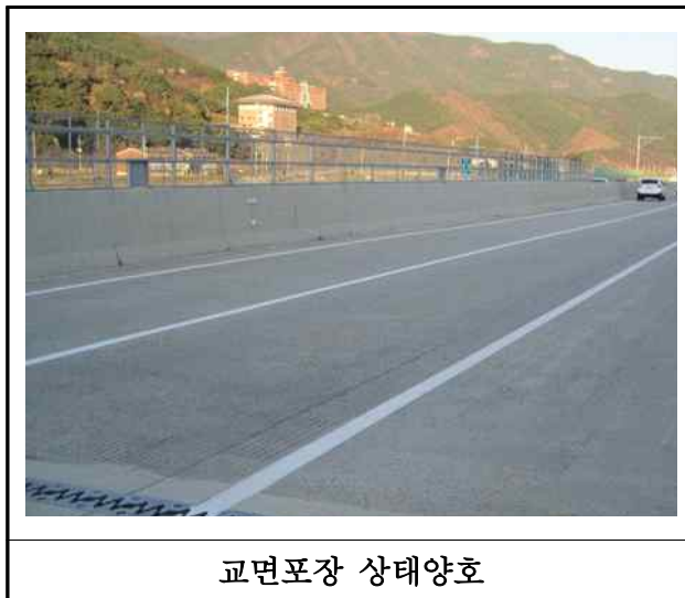
【사진 21.3.43】 교면포장 손상현황
