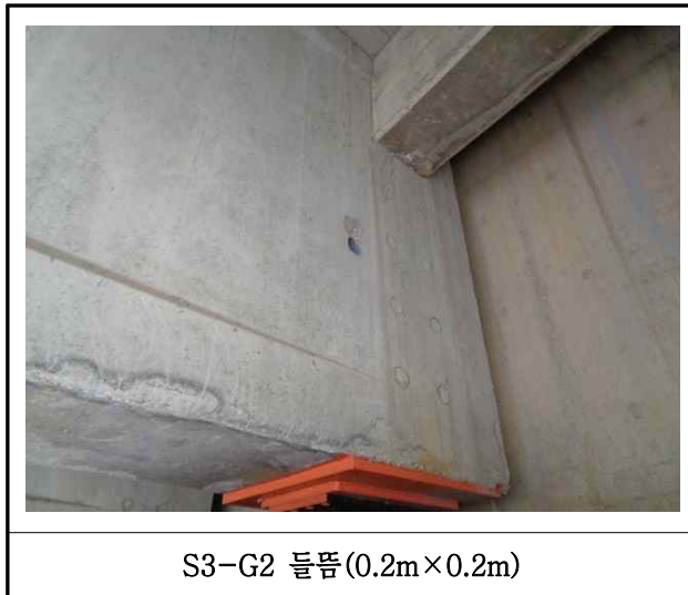
【사진 21.3.28】 거더 손상현황
