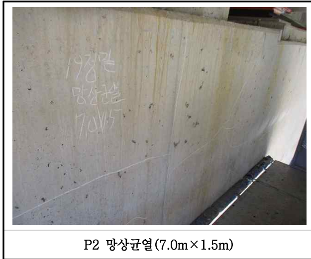
【사진 21.3.34】 교각 손상현황
