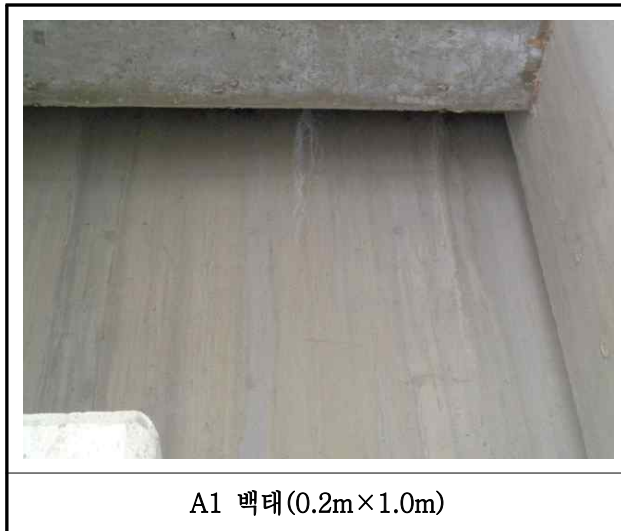
【사진 21.3.32】 교대 손상현황
